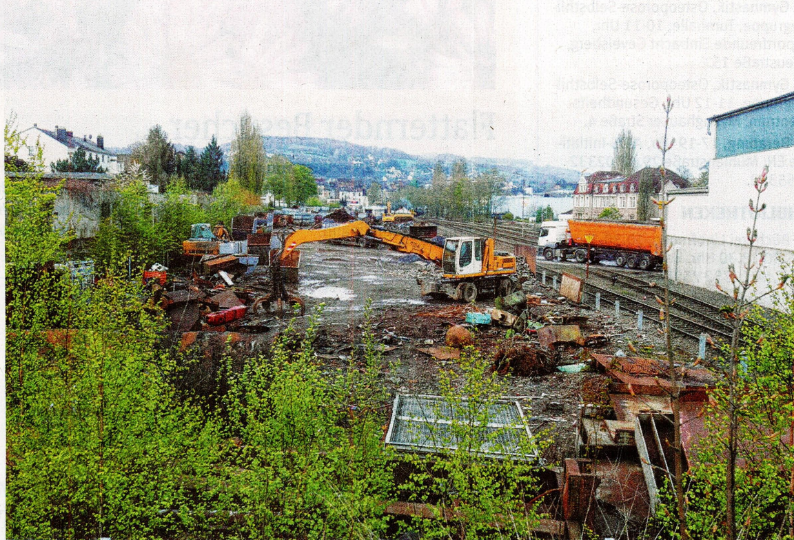
Auf dem Gelände der ehemaligen Firma Schüssler in Gevelsberg soll die neue Feuerwache entstehen. Der Gehweg soll während der Bauarbeiten offen bleiben. Die Spaziergänger können den Fortschritt beobachten.
